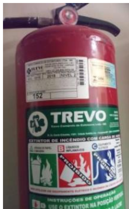
Extintor de incêndio com validade expirada
