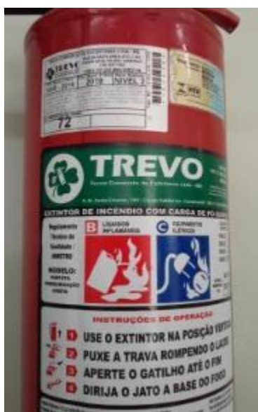
Extintor de incêndio com validade expirada
