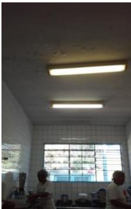
Teto da cozinha com infiltrações
