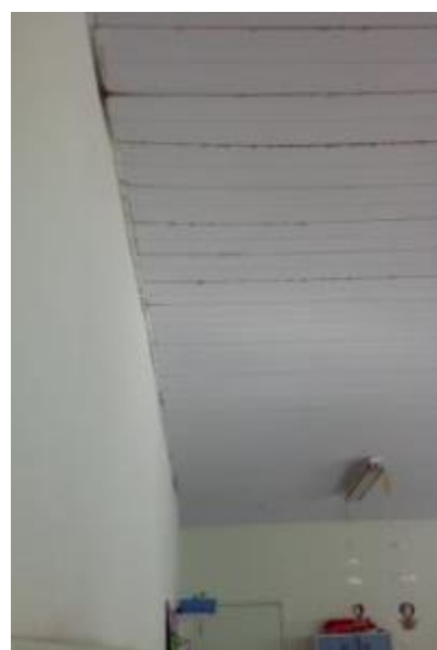
Forro com necessidade de reparos
