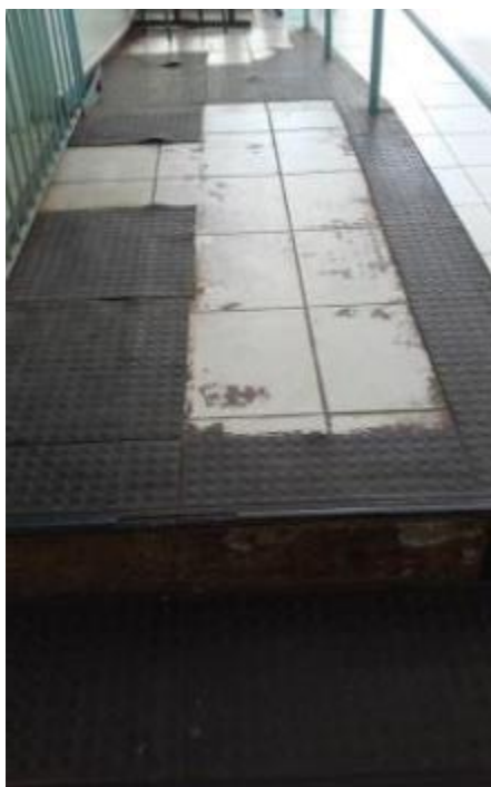
Piso antiderrapante com avarias
